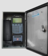
Coffret de distribution
